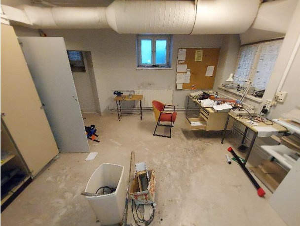
Mm. 065 huonetilassa 2-laattaisessa alapohjassa irtovesi alapohjan eristetilassa
