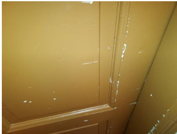
Osa väliovista on maalipinnaltaan kolhiintumisen seurauksena huoltomaalauksen tarpeessa, muita puutteita ei havaittu.
