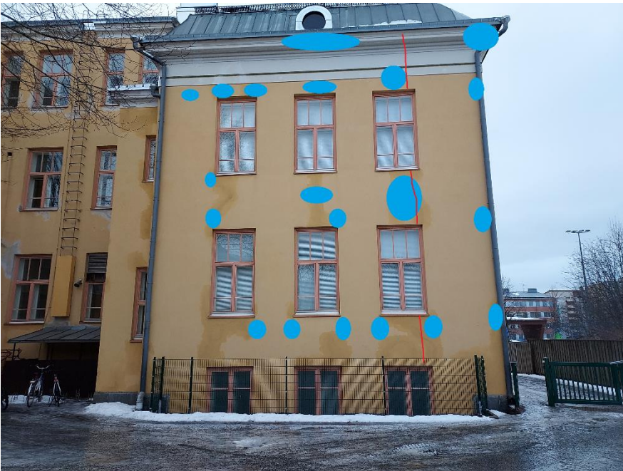
Sisäpihan seinusta, punaisella viivalla osoitettu seinässä havaittu halkeama.
