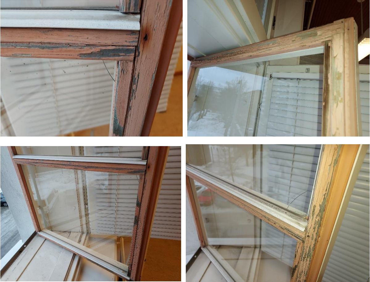
Ikkunoiden ulkopinnat ovat huoltomaalauksen tarpeessa
