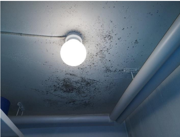
003 kuiva-ainevarastossa mikrobikasvustoa kattopinnalla
