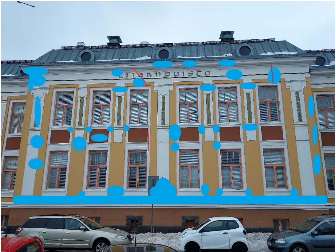
Annankadun puoleinen laita, keski-osa. Seinällä 2 halkeamaa, osoitettu punaisella viivalla.
